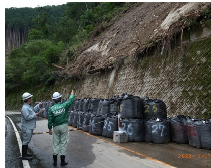
斜面地緊急点検 枚方亀岡線【土砂崩落現場】
