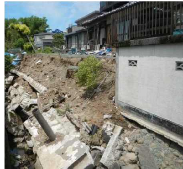
人工斜面崩壊状況(熊本県益城町)
