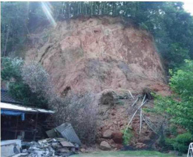
自然斜面崩壊状況(熊本県益城町)
