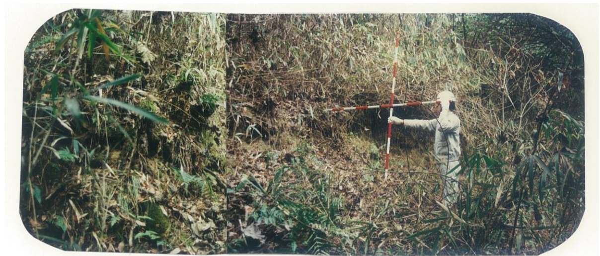
①地すべり冠頭部滑落崖の状況 昭和62年対策工事完成後拡大はみられない
